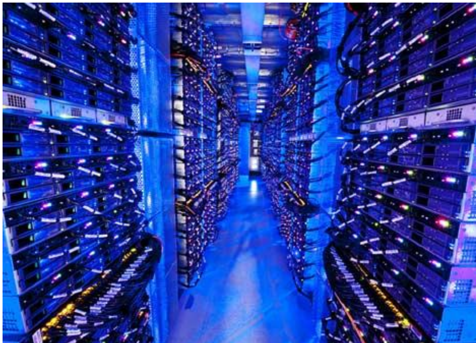
Serverovny datacenter bývají opravdu, opravdu rozsáhlé. Operační systém musí hlídat všechny servery a řešit rozdělení úloh, pokud se některý z nich porouchá. (Zdro: Wake TSI)
