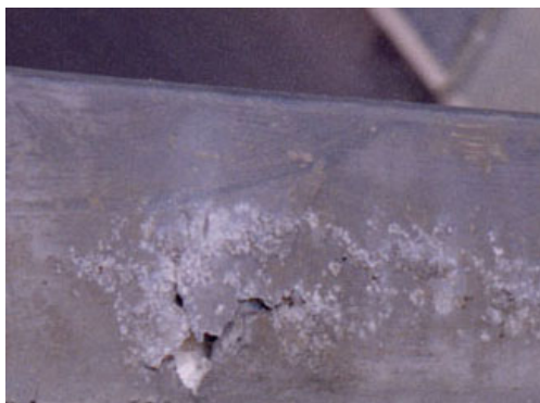
Obr. 27. Korozní poškození „titanzinkového“ plechu po dvou letech expozice v kontaktu s tepelnou izolací budovy
