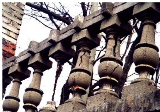
Obr. 35. Betonové zábradlí, popraskané po aktivaci ocelové výztuže v důsledku karbonatace betonu
