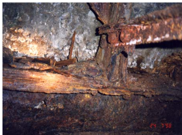
Obr. 26a. Koroze ocelové konstrukce v betonových podstavcích sousedí Trig na Národním divadle v Praze
