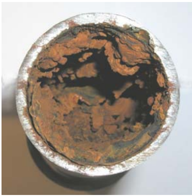
Obr. 33. Koroze uhlíkové oceli v pitné vodě
