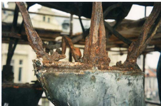
Obr. 29. Korozní poškození kostry měděné plastiky
